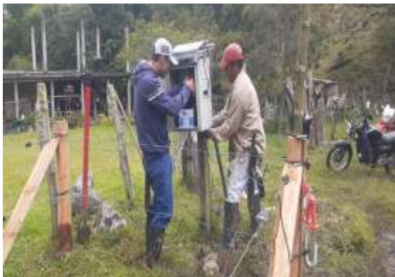
Instalación Panel solar SSP municipio de Florida
