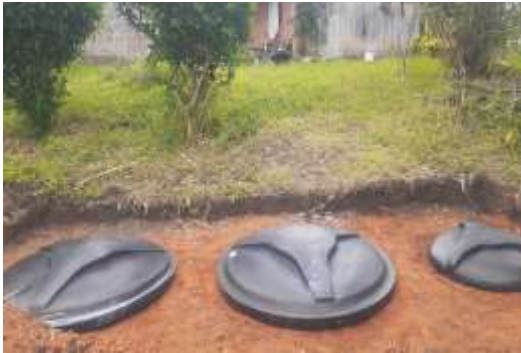
Sistema séptico Instalado municipio de Florida
