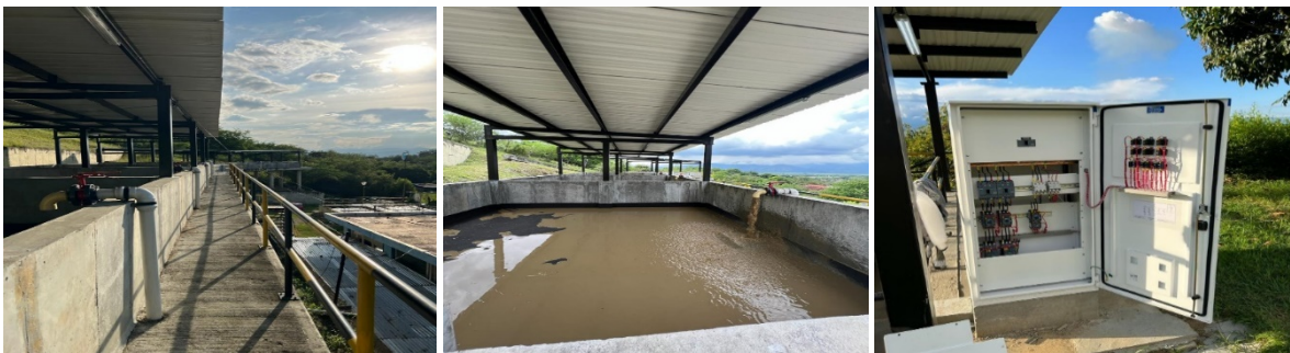
Construcción Sistema Tratamiento de Lodos y Optimización PTAP Municipio de San Pedro
