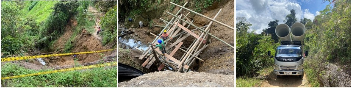
Construcción obras de mitigación por daño tubería Aguas Residuales Municipio de El Cairo
