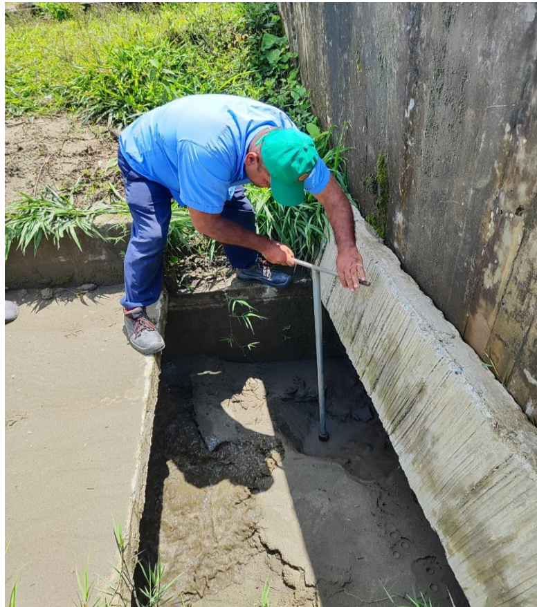
Foto 3. Taponamiento total por lodos del sistema de desarenadores Andalucía
