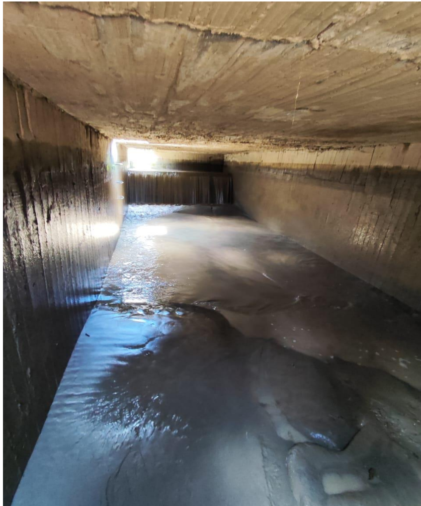
Foto 4. Desarenadores Bocatoma voladeros – Marzo 2023
