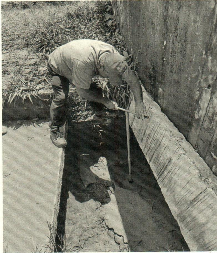
Foto 3. Taponamiento total por lodos del sistema de desarenadores Andalucía
