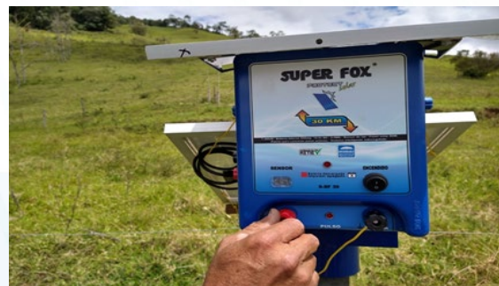
Panel solar SSP municipio de Restrepo
